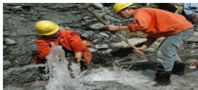
2、基坑开挖后，基地出现突涌，水量一般较大
