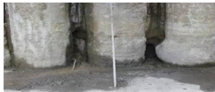
3、三轴搅拌桩渗漏、漏土
