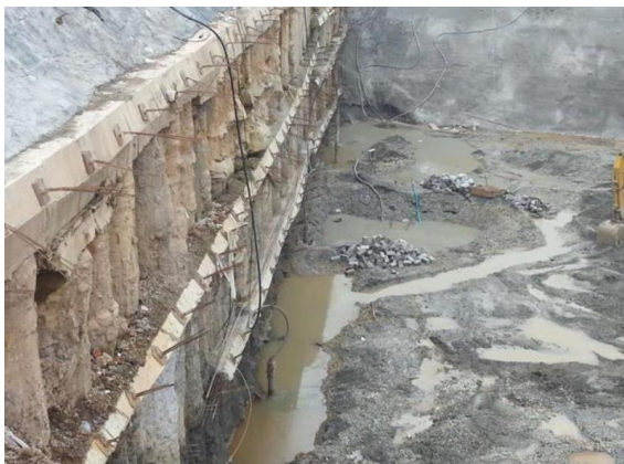
1、基坑局部返水或渗水，低洼处积水严重
