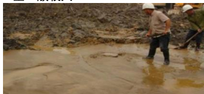
3、基坑底部土壤泌水，土壤逐渐软化
