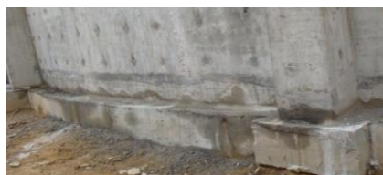
2、地下连续墙自身渗漏和接缝处渗漏
