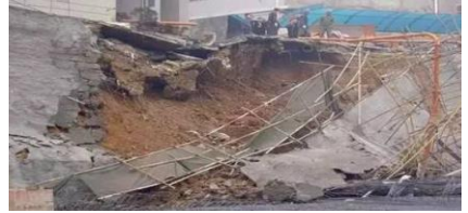
2、围护桩深度不足，导致基坑边坡倒塌
